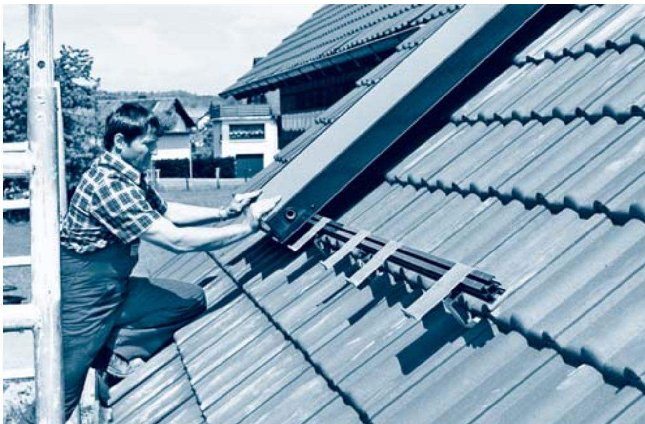
Dank Standardkomponenten sind Solar-Flachkollektoren auf dem Dach rasch installiert. Bild: Viessmann Schweiz AG
