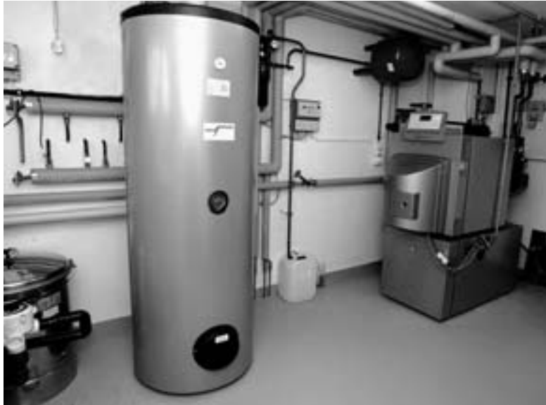
Beispiel einer kombinierten Öl-Solar-Heizung mit Heizkessel und Speicher. Bild: Informationsstelle Heizöl
